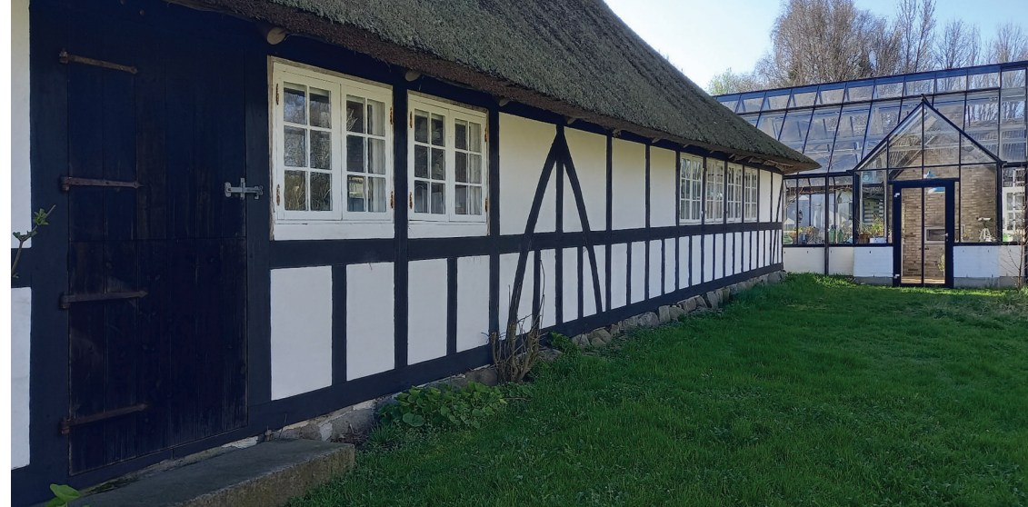
Sulelængen set fra vest signalerer med sine sprossvinduer snarere "beboelse" end "stald". Se vores overvejelser vedrørende dette s. 15-16.
